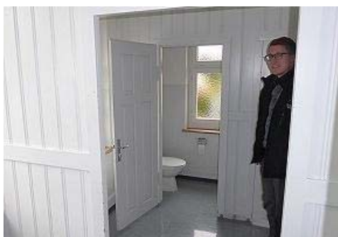
Das Bild der WC-Anlage im Haus 1 bestätigt dessen Erneuerungsbedarf.
